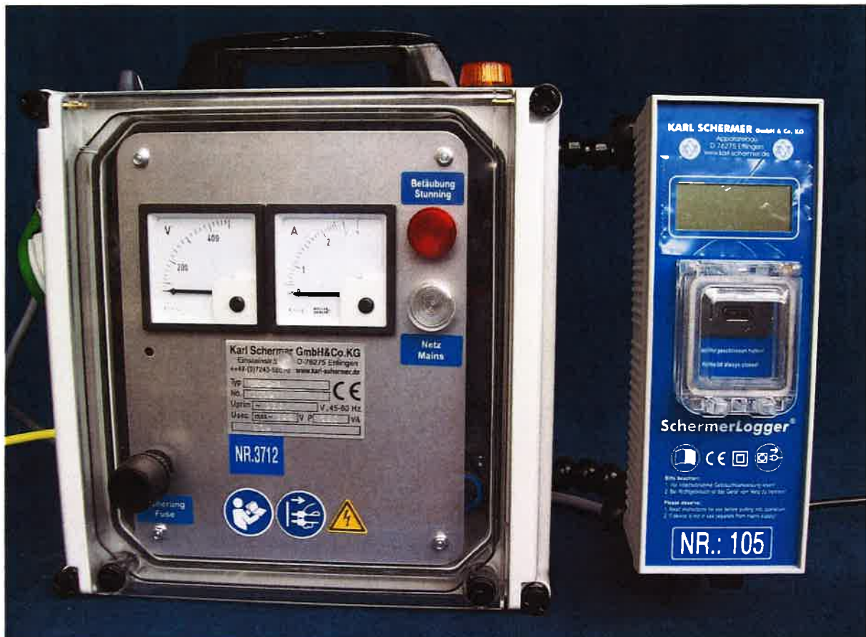
SchermerLogger am Betäubungstransformator montiert
