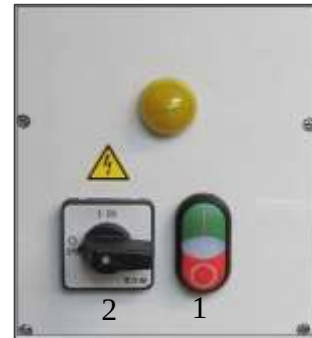
Fig. 7-10 Control de seguridad SVSS
