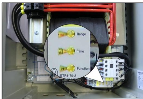
Sl. 5-4 Časovni rele v transformatorju TR7
