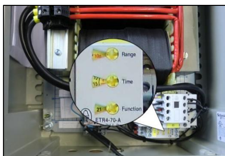
Рис. 5-4 Реле с выдержкой по времени в трансформаторе TR7
