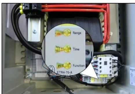
Rys. 5-4 Przełącznik czasowy w zasilaczu transformatorowym TR7
