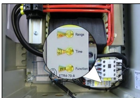
III. 5-4 Relais temporisé dans le transformateur TR7
