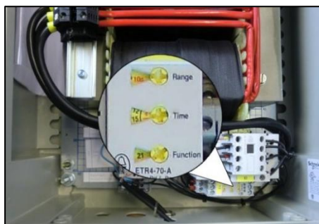
II. 5-4 Relé temporizador en el transformador TR7
