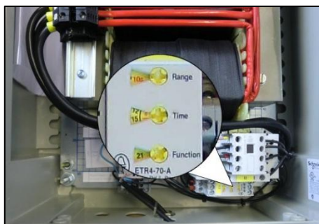
Abb. 5-4 Zeitrelais im Transformator TR7
